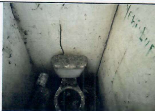
Foto 10: (BAÑOS) La sustitución de inodoros, es una prioridad en el modulo de servicios sanitarios de las niñas.
