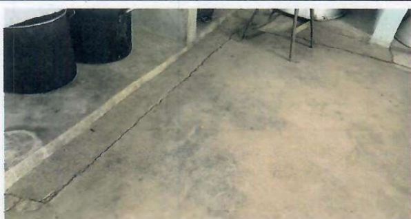
Foto 5: (COCINA) El piso de la cocina necesita colocarle piso cerámico.
