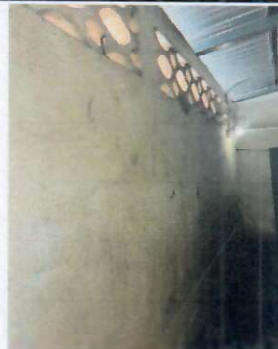
Foto 14: (BAÑOS) El módulo de servicios sanitarios necesita pintura duradera, de las cuales, se desea aplicar pintura de aceite a las paredes.
