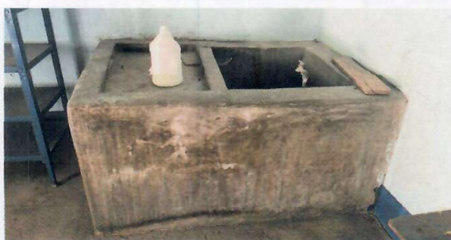
Foto 3: (COCINA) La pila de la cocina necesita remozamiento instalándole azulejos.
