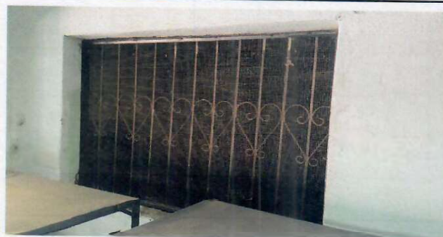
Foto 8: (COCINA) La cocina presenta debilidades en las ventanas, por lo tanto, se pretende colocar ventanas de PVC.
