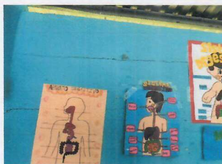
Foto 2: (AULAS) En las aulas de primero y tercer grado se encuentran varias fisuras en la pared.
