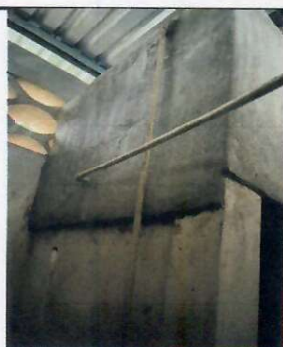
Foto 15: (BAÑOS) La línea de conducción de agua para los inodoros está en pésimas condiciones.
