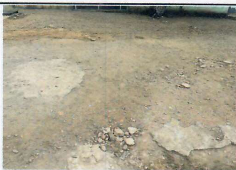
Foto 17: (PATIO) El ingreso al centro educativo, presenta problemas porque las tortas de concreto están en malas condiciones.
