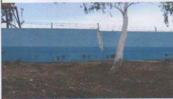
Foto 7: Pintura en muro perimetral.
