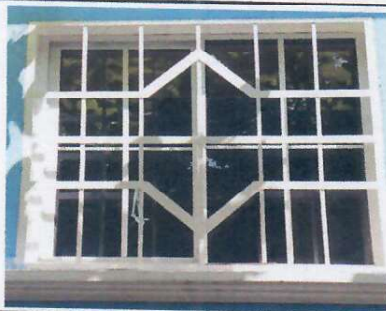
Foto 3: VENTANAS QUE REQUIEREN MANTENIMIENTO
