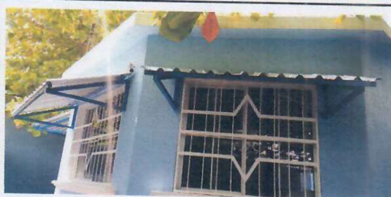
Foto 4: VENTANAS QUE REQUIEREN DE ESTRUCTURAS DE PROTECCION SOLAR
