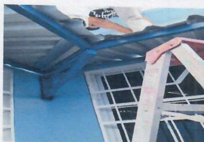
Foto 4: VENTANAS QUE REQUIEREN DE ESTRUCTURAS DE PROTECCION SOLAR
