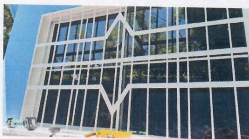
Foto 3: VENTANAS QUE REQUIEREN MANTENIMIENTO
