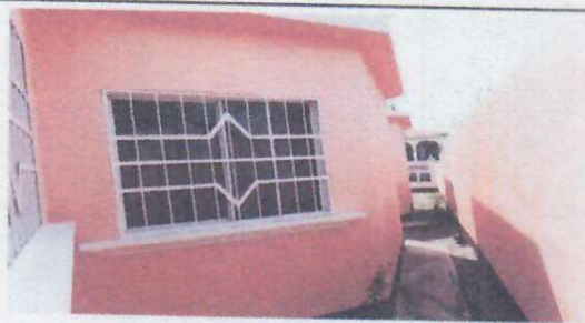
Foto 4: VENTANAS QUE REQUIEREN DE ESTRUCTURAS DE PROTECCIÓN SOLAR
