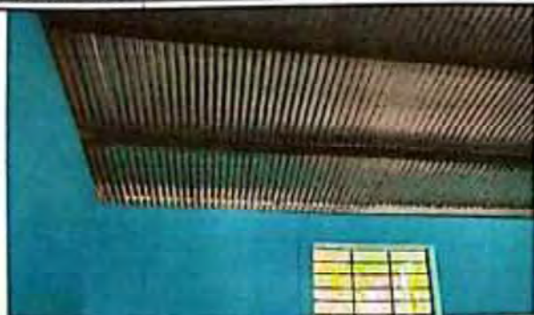
Foto 7: SELLADO ENTRE FINAL DE MUROS Y TECHO EN AULA.
