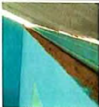
Foto 7: SELLADO ENTRE FINAL DE MUROS Y TECHO EN AULA.
