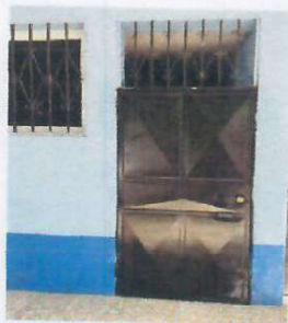
Foto 1: PUERTA A SUSTITUIR
