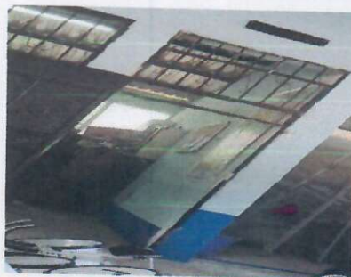
Foto 1: PUERTA A SUSTITUIR
