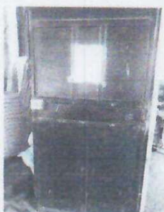
Foto 1: PUERTA A SUSTITUIR
