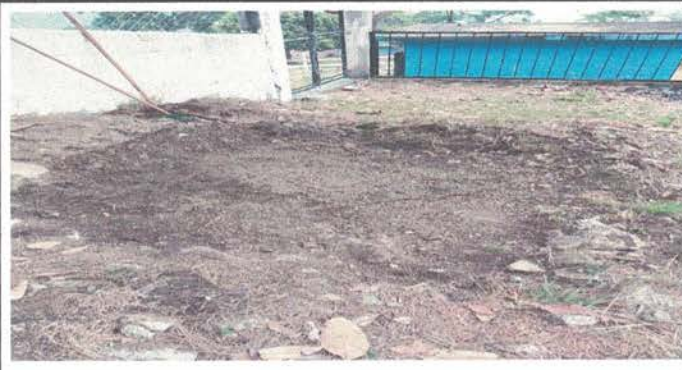
Foto 2: Seguimiento de fosa séptica para servicios sanitarios.
