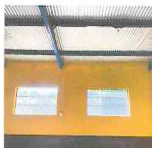
FOTO 6: REPELOS DE PAREDES
