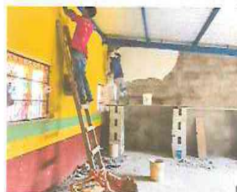
FOTO 6: REPELOS DE PAREDES
