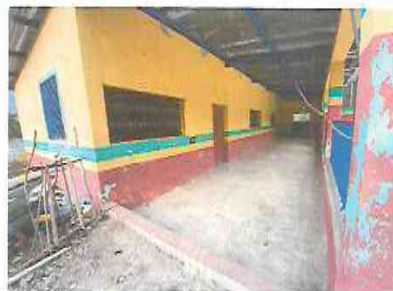
FOTO 6: REPELOS DE PAREDES
