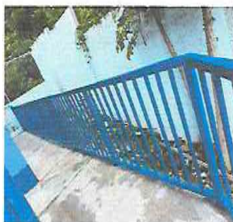
FOTO 9: INSTACIÓN DE BARRANDA DE METAL
