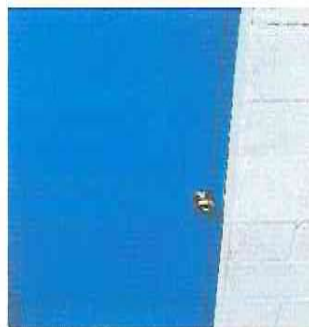
FOTO 6: SUSTITUCIÓN DE CHAPA BOLA POR PASADORES EN PUERTA
