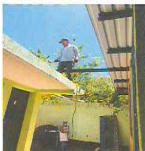
FOTO 1: CONTINUACIÓN DETECHADO EN AREA DE PILA, CON LAMINA TROQUELADA CAL. 26
