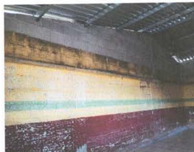
FOTO 16: REPELLO CAPA GRIS EN AULA DE PARVULOS
