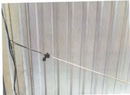
FOTO 7: INSTALACIÓN ELECTRICA ILUMINACIÓN Y FUERZA (CABLE, TOMACORRIENTES, APAGADORES Y LAMPARAS)
