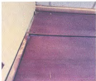
FOTO 11: PARED DE MADERA EN MAL ESTADO
