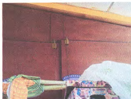
FOTO 10: PARED DE MADERA EN MAL ESTADO
