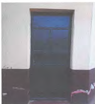
FOTO 15: PINTURA EN PUERTAS
