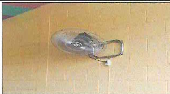
Foto 2: Sustrucción de ventiladores.
