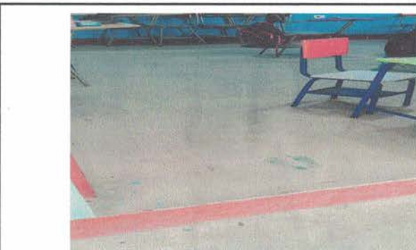
Falta de piso granito en Aulas
