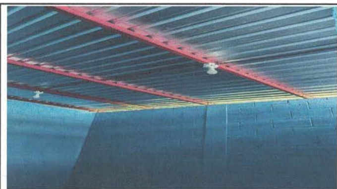
Falta de Cielo Falso en Aulas
