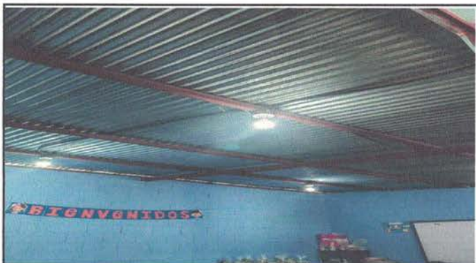
Falta de Cielo Falso en Aulas
