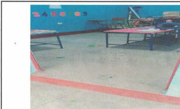
Falta de piso granito en Aulas
