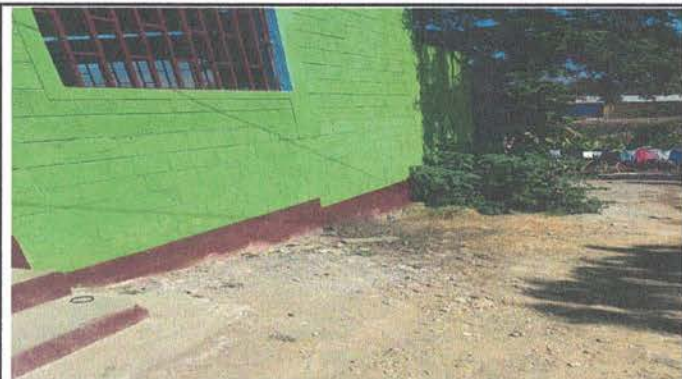
Falta de banqueta en el ingreso de la escuela
