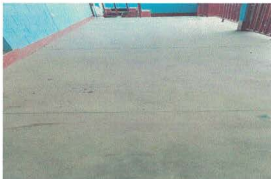
Falta de piso de granito en corredor
