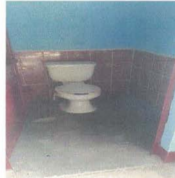
Falta de piso de granito en baños
