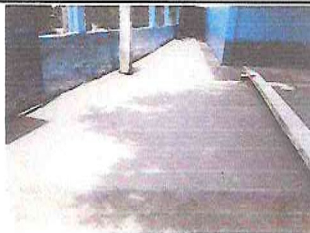
Foto 2: Torta de concreto trabajado
