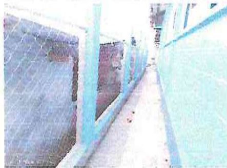
Foto 2: Cunetas parte posterior de aulas de párvulos
