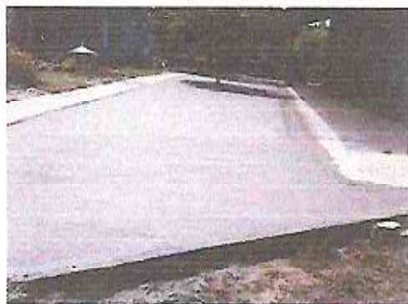
Foto 1: Torta de concreto trabajado
