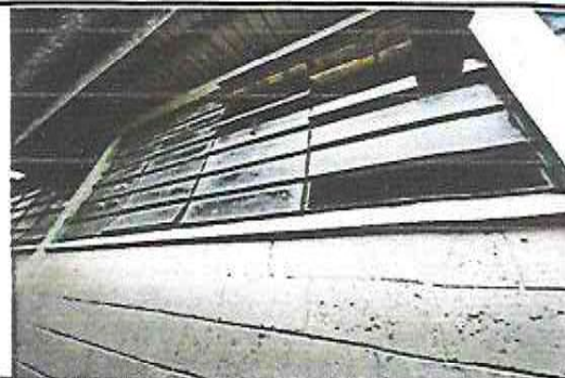
Foto 4: Suministros de ventas corredizas de tubo PVC
