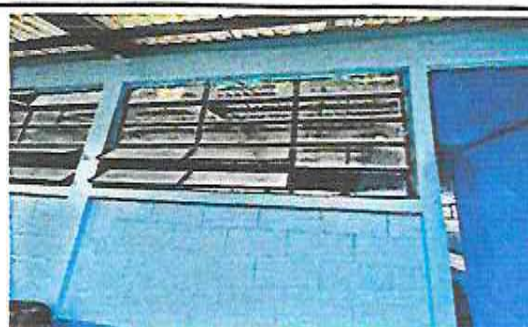
Foto 4: Suministros de ventas corredizas de tubo PVC
