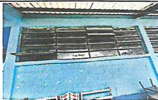
Foto 2: Suministros de ventas corredizas de tubo PVC
