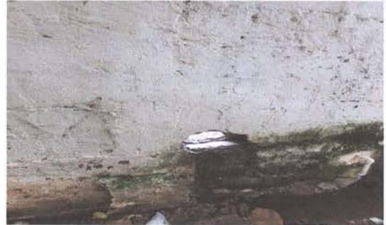
CERNIDO EN MURO PERIMETRAL
