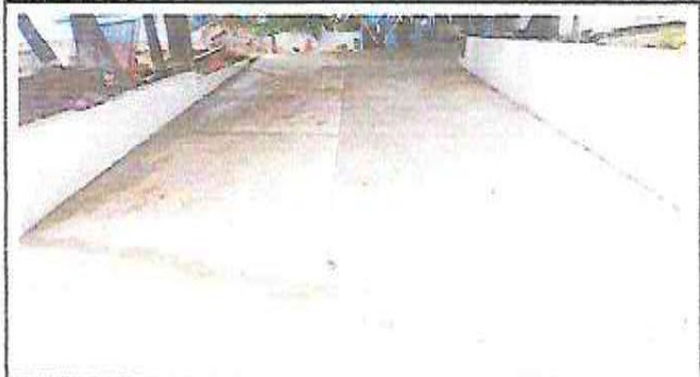
Foto 2: Sustrucción de rampa de entrada principal de concreto por material de la misma consistencia.
