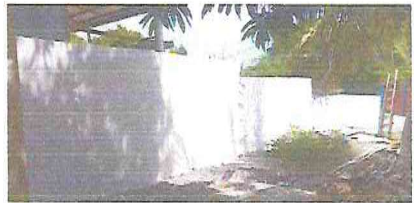
Foto 8: Cernido en paredes.
