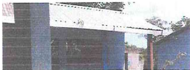
Foto 9: Suministro e instalación de canal de metal y tubo bajante de agua pluvial
