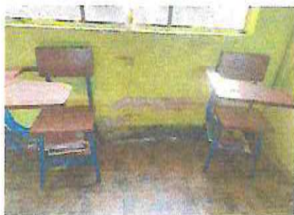
Foto 9: Cernido en muros
