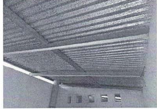
Foto 2: interior del techo el cual es de madera y presenta ya desperfectos.
