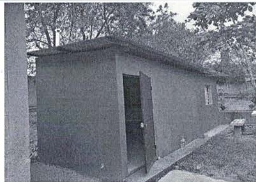
Foto 3: modulo de cocina que necesita cambio de techo y lamina.
