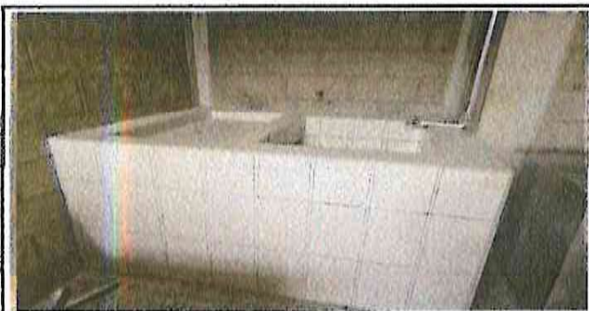
Foto 5: finalización de pila de dos lavadores
