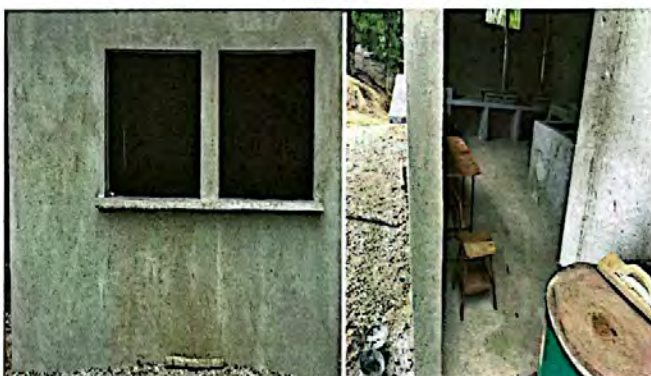
Foto 4: Cocina que necesita puerta y ventanas de metal
