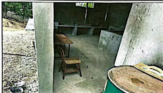
Foto 1: Cocina que necesita cambio de piso de cemento por cerámico
