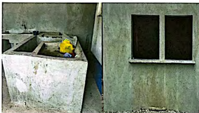
Foto 3: Cocina que necesita instalación de cerámica en, pila, pasamanos y lavatrastes
