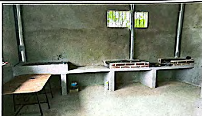
Foto 2: Cocina que necesita fachaleta tipo ladrillo en el area de la cocina rural
