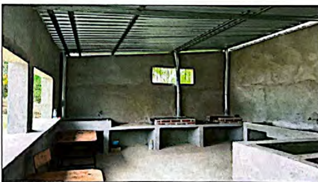
Foto 6: Se necesita en la cocina instalación de canaletas de 3/3 y mangera de cable de 1/2
