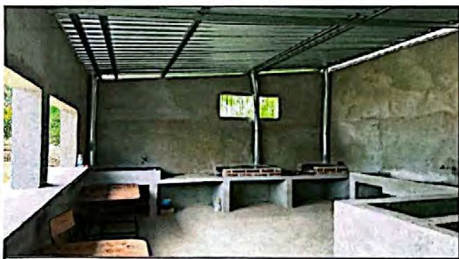
Foto 5: Cocina que necesita instalación de servicio de energía electrica, como instalación de cableado, cajas redondas para plafonera, plafonera, tapaderas, tomacorrientes, apagadores y bombillas
