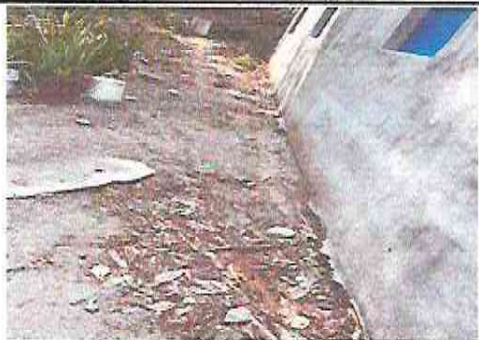
FOTOGRAFIA: PISO DE TORTA DE CONCRETO, MURO DE CONTENCIÓN EN MODULO DE CORREDOR
