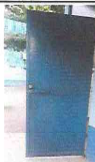
Foto 18: SUSTITUCIÓN PUERTA EN MAL ESTADO
