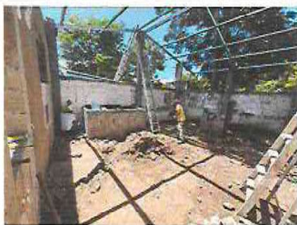
Foto 1: Sustrucción de lavatrstos por pila de concreto formal
