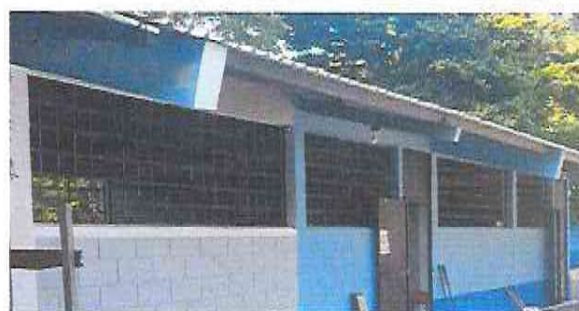
Foto 16: QUITAR VIDRIOS EN MAL ESTADO
