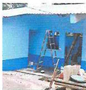
Foto 5: Sustrucción de puerta de metal de la cocina
