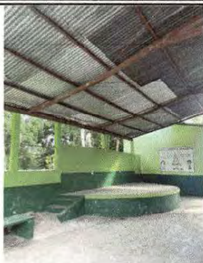
Foto 7: Módulo C, estructura metálica en mal estado
