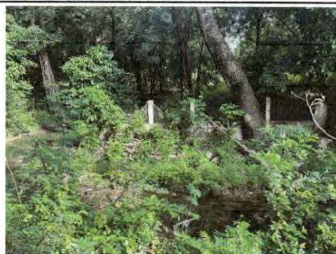
Foto 10: Módulo D, muro perimetral dañado
