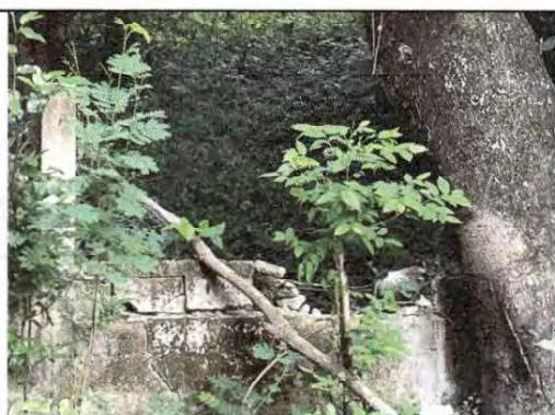
Foto 9: Módulo D, muro perimetral en mal estado
