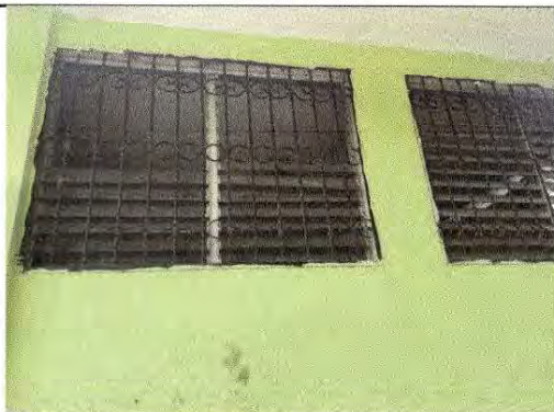
Foto 3: Módulo A, ventanas con vidrios incompletos
