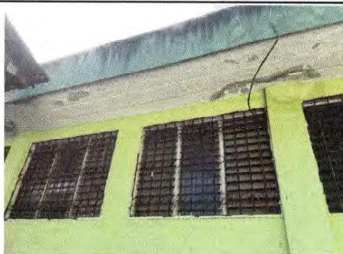
Foto 5: Módulo B, humedad en techo
