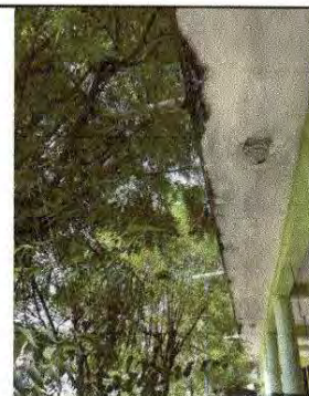
Foto 6: Módulo B, techo en mal estado por humedad
