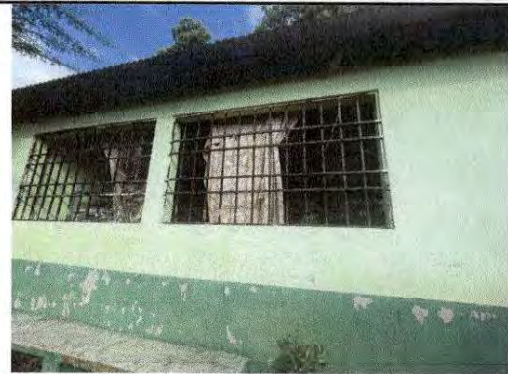
Foto 2: Módulo A, ventanas sin vidrios
