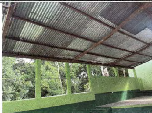
Foto 8: Módulo C, láminas dañadas por árboles frutales
