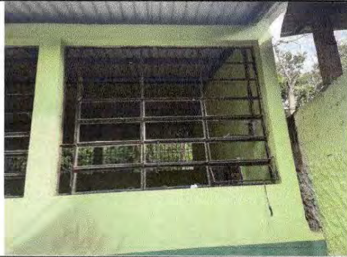
Foto 1: Módulo A, ventanas sin vidrio
