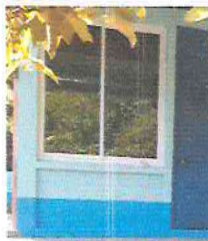
Foto 10: Sustrucción de estructura metálica y vidrios dañados por ventanas corredizas de tubo pvc
