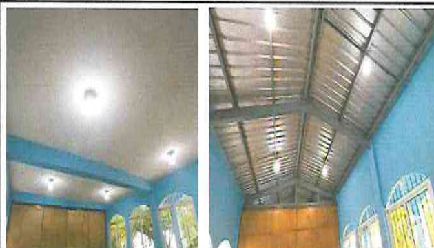
Lámparas ahorradoras instaladas en el interior de los salones de clases del primer nivel y segundo nivel.
