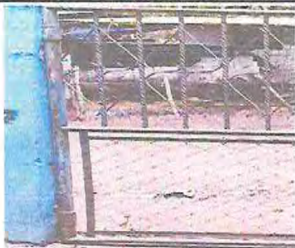
Foto 3: Porton en muy mal estado.
