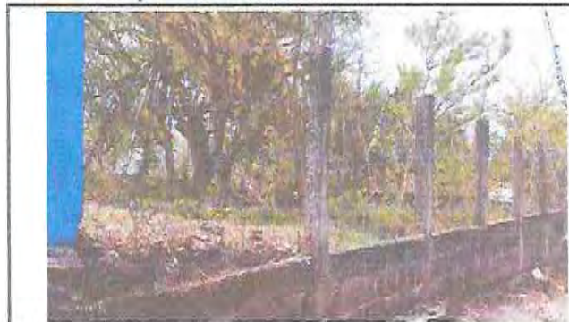
Foto 4: Muro perimetral con malla en mal estado.
