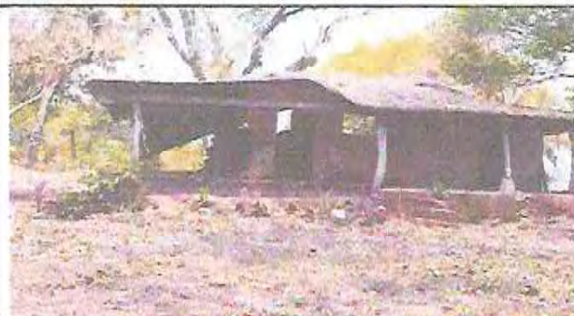
Foto 5: Infraestructura de la cocina en mal estado
