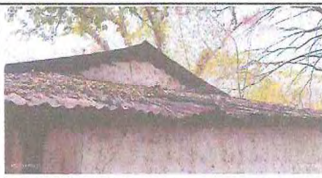
Foto 6: Techo de la cocina con ocos y en muy mal estado.
