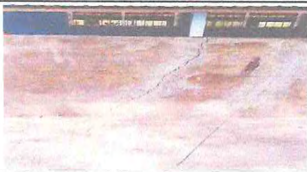
Foto 3: Pila con grieta por el sol continua
