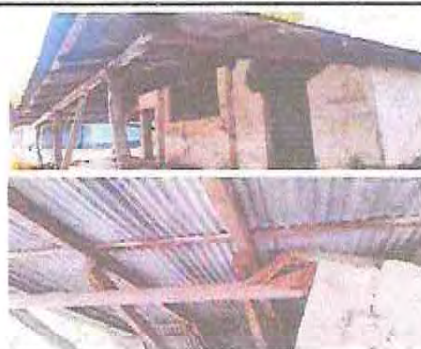
Foto 4: Por el deterioro a traves de las lluvias las paredes se ven vulnerables
