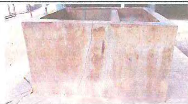
Foto 2: Pila con grieta por el sol continua
