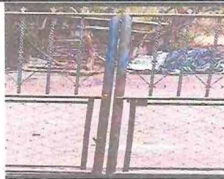
Foto 4: Porton en muy mal estado.
