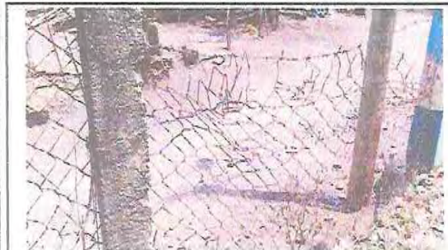
Foto 3: En mal estado por vecino que entran a la escuela
