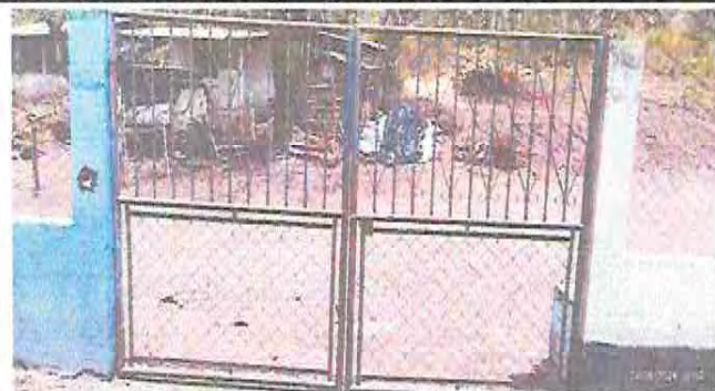
Foto 1: Porton en mal estado
