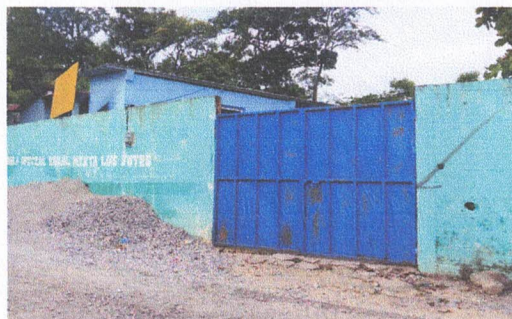
Foto 5: Cernido en muro perimetral frontal
