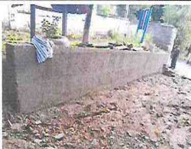
Repello en pared de la entrada, lado derecho.
