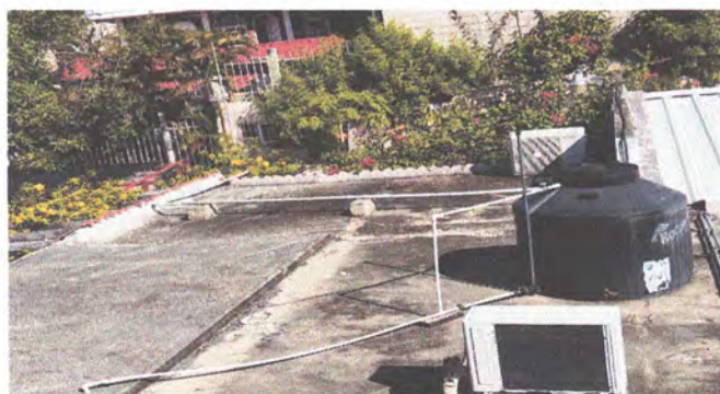
Foto1: Terresa de Dirección del establecimiento, la cual tiene filtración de agua. Y gotea adentro de la dirección.
