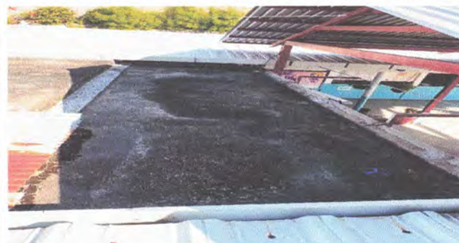
Foto 2: Parte de la terraza del area de Dirección que tiene filtración de agua.
