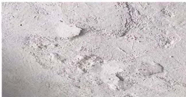
Foto 5: Daños en repello de terraza por el problema de la filtración.
