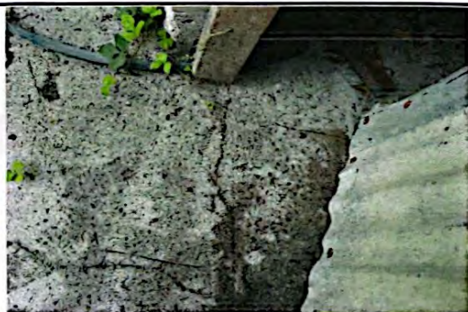
Foto 7: Sustrucción de piso de torta de concreto
