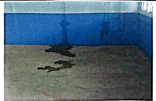
Foto 12: Repello y cernido en paredes, por filtración de agua, interior.
