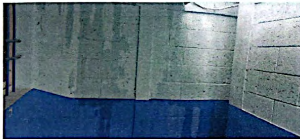
Foto 9: Repello y cernido en paredes, por filtración de agua, exterior.
