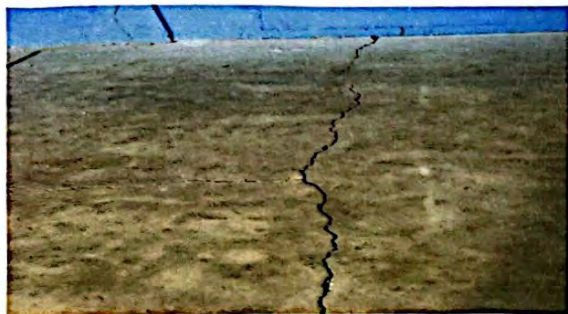
Foto1: Sustrucción de torta de cemento dañada, por piso cerámico
