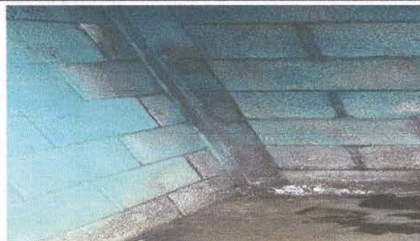
Foto 2: azulejo en muros de sanitarios
