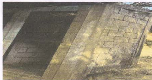
Foto 6: repello en pared de sanitarios
