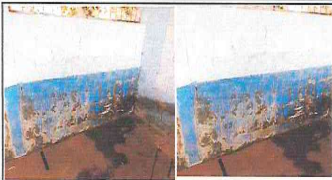
Foto 1: Repello de pared por filtración de agua.
