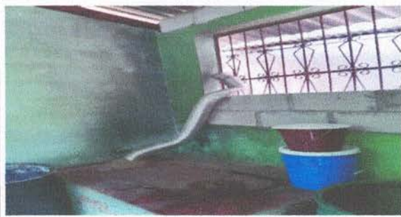
Sustitución de estufa rural incluye chimenea y plancha de metal
