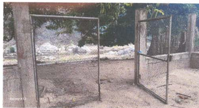
Mantenimiento de Portones
