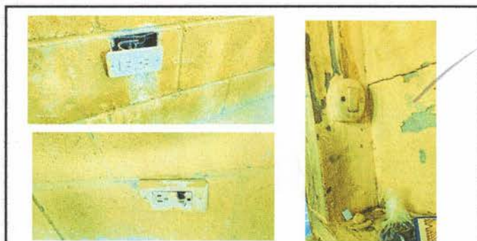
Foto 6: se necesita reparacion del sistema electrico
