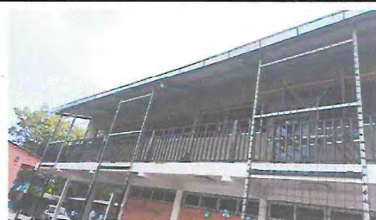
Foto 2: CONTINUIDAD VERTICAL DE BARANDA EN SEGUNDO NIVEL.
