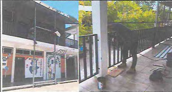
Foto 1: CONTINUIDAD VERTICAL DE BARANDA EN SEGUNDO NIVEL.
